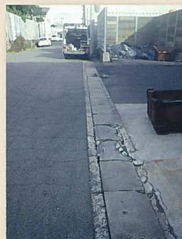
ケース③ 既設側溝、割れ、破損。
