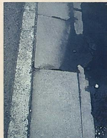
ケース① 現場打ち側溝の アゴの破損。
